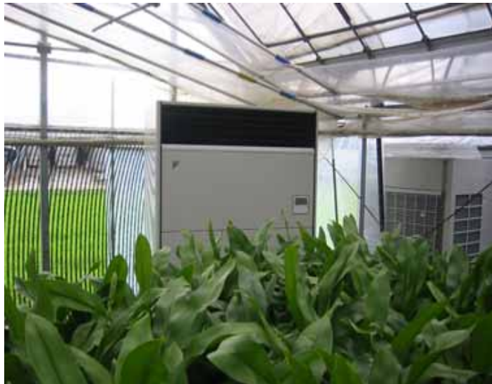
【開花棟のエアコン設置状況その2】
