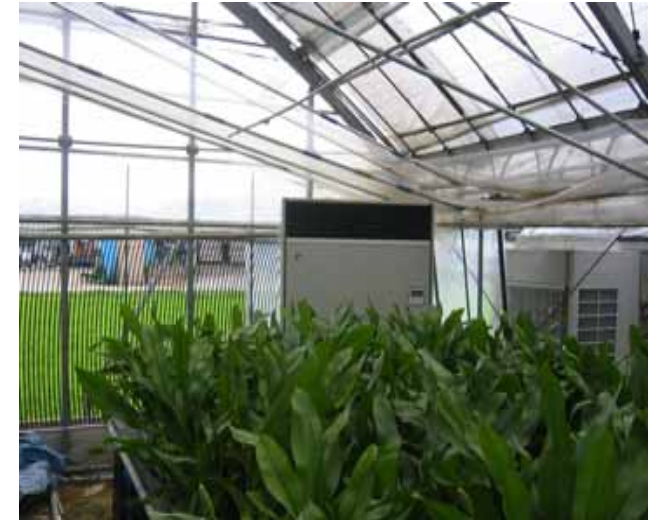
【開花棟のエアコン設置状況その1】
